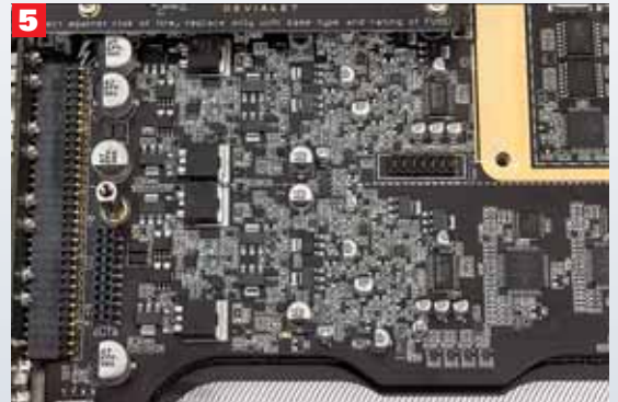
5 Für einen 350-Watt-Amp alles andere als typisch präsentiert sich seine Class A-Endstufe. Sie erwärmt sich kaum und benötigt weder ein großes Netzteil noch ausladende Kühlkörper
